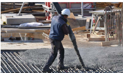
Abb. 12: Arbeiten mit der Betonpumpe, Bewehrungsstahl erhöht die Druck- und Zugfestigkeit. Bildquelle: © BetonBild
