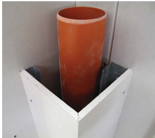
Abb. 5: Mit Hilfe eines einfachen Formteiles, wie dem L-Winkel, lassen sich Ecken leicht und schnell montieren. Foto: KOMZET BAU BÜHL
